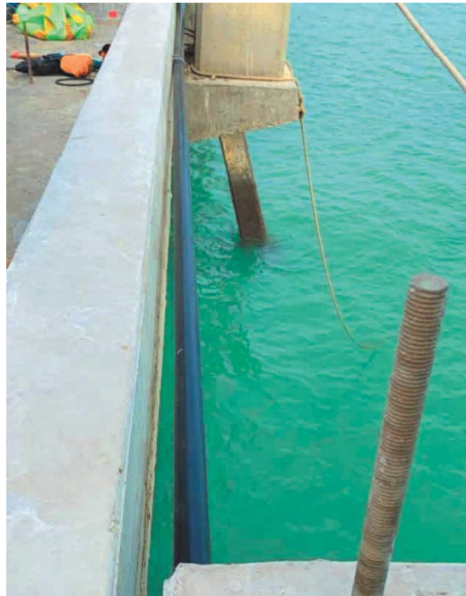
TUBERIA CODUIT PARA ILUMINACION DECABEZO 02
